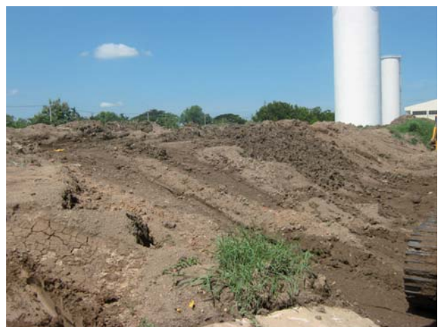
รูปที่ 3 ลานตากตะกอน (Drying yard) ที่โรงผลิตน้ำประปาบางเขน
